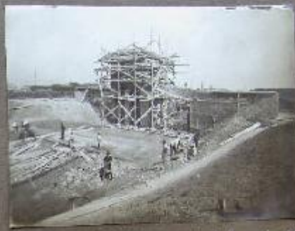
Vista da valle durante i lavori di investimento della scarpata e costruzione del tetto
