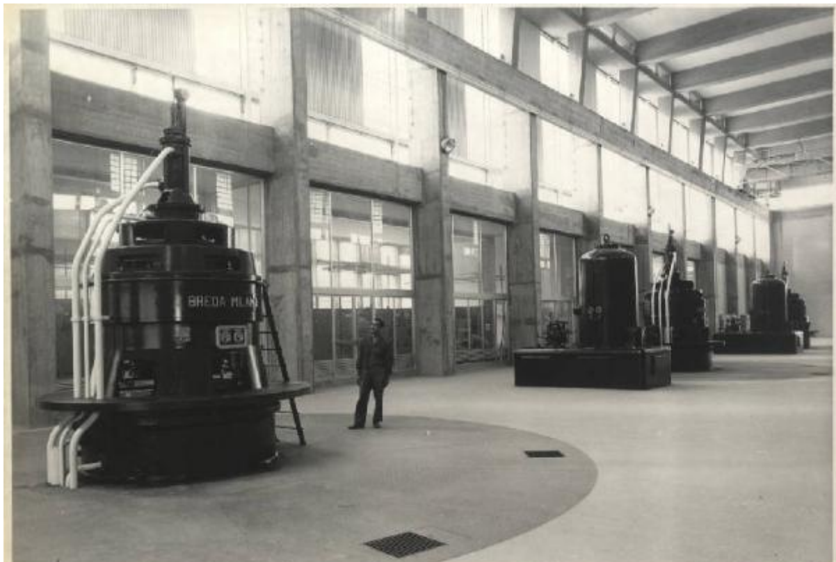
1957 - 3 Alternatori 6.700 kVA - 10.000 V - 50 Hz - 107,2 giri/1' per Società Idroelettrica Tevere - C.le di Ponte Felice
