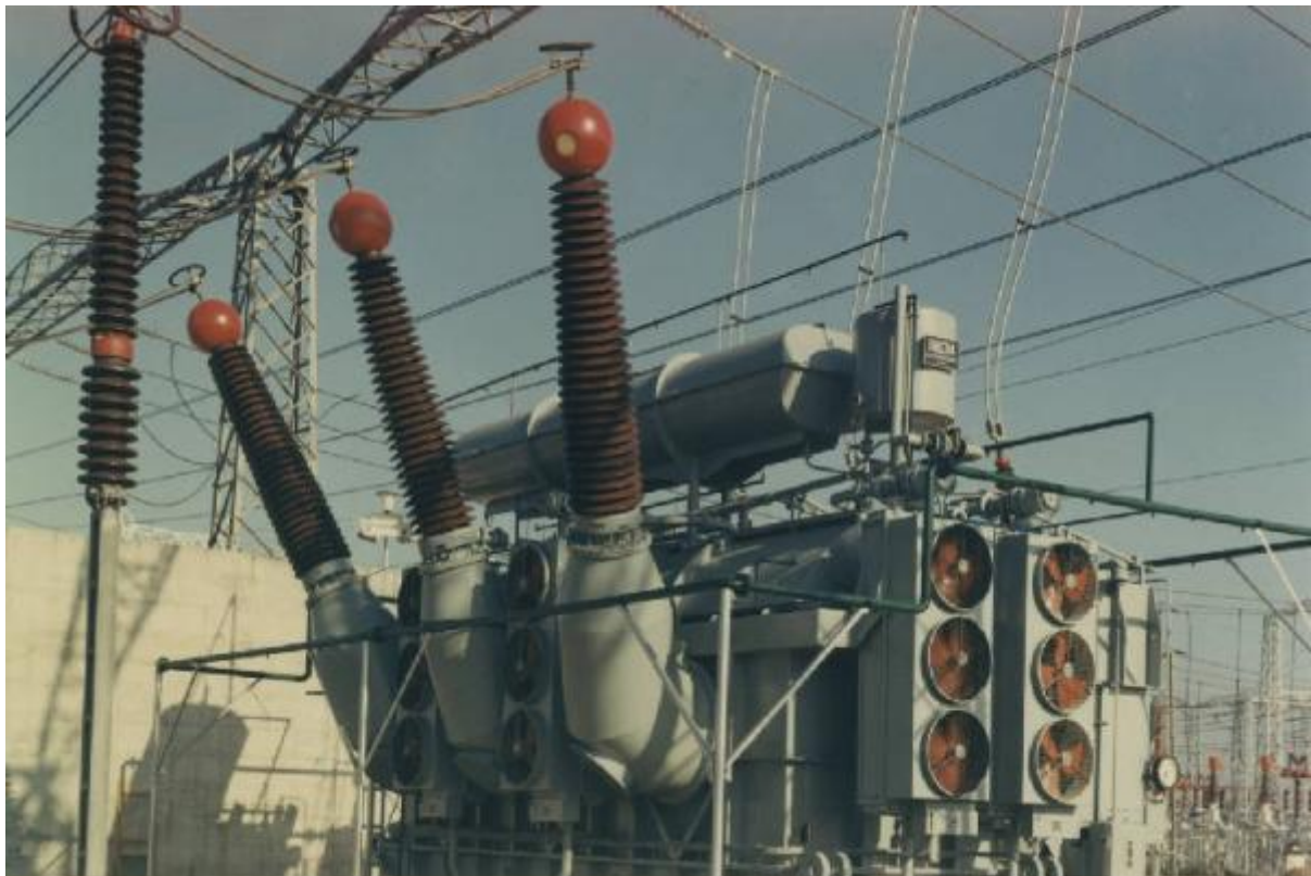
10824/962 - 2 Autotrasformatori da 250/250/70 MVA - 400/135+6x3,38/15 kV - 50 Hz per ENEL - Compartimento di Milano Stazioni elettriche di Baggio e Bovisio
