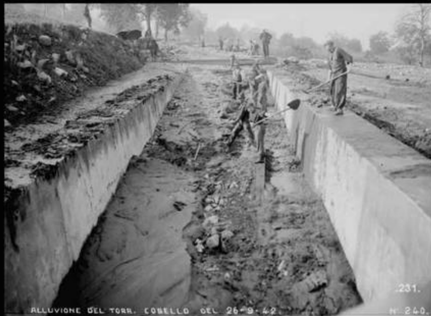
ALLUVIONE DEL TORR. COBELLO DEL 26-9-42.
